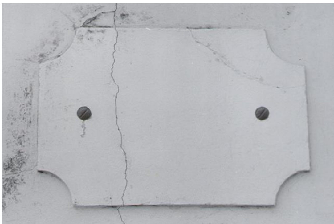
Figura 20. Parafusos de fenda em residência do Distrito da Guardinha em São Sebastião do Paraíso, MG (detalhe)
